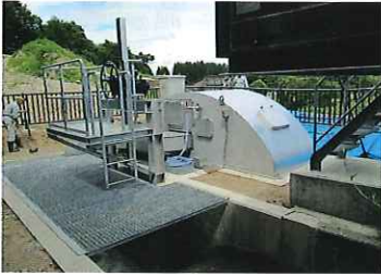
萩生分水工取水口除塵機
