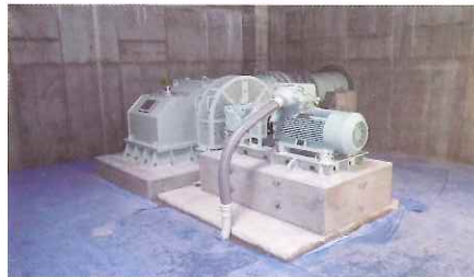
水車・発電機・入口弁・片落管
