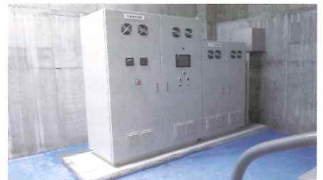
発電機盤・変圧器盤
