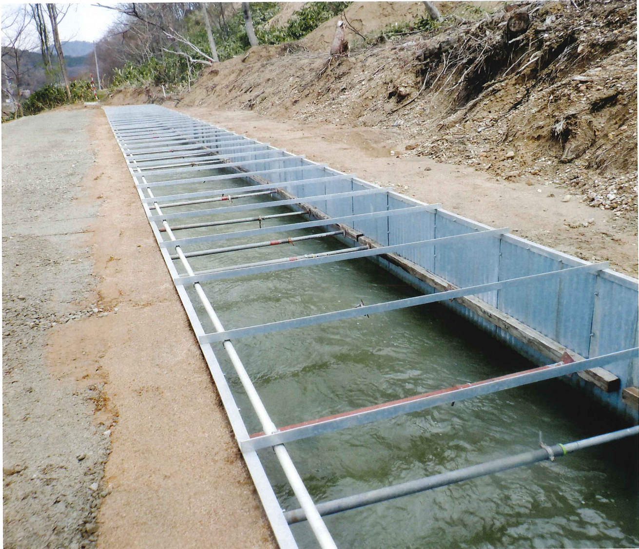
令和4年8月3日、4日豪雨災害により被災した白川幹線用水路の仮復旧工事完了
