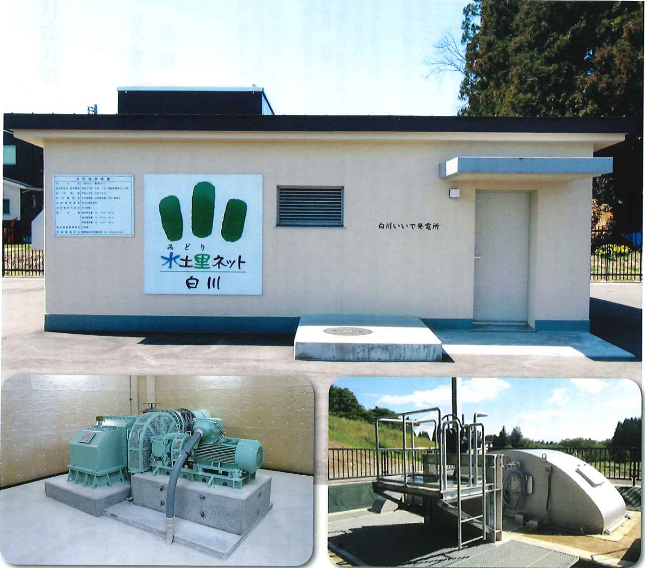
白川いいで発電所 (クロスフロー水車と発電機、取水工除塵機)
